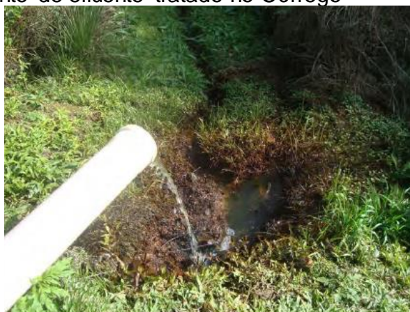
Figura 62 – Lançamento de efluente tratado no Córrego
