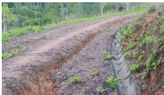
Figura 57. Caminho de entrada do antigo lixão, e calha para escoamento da água da chuva
