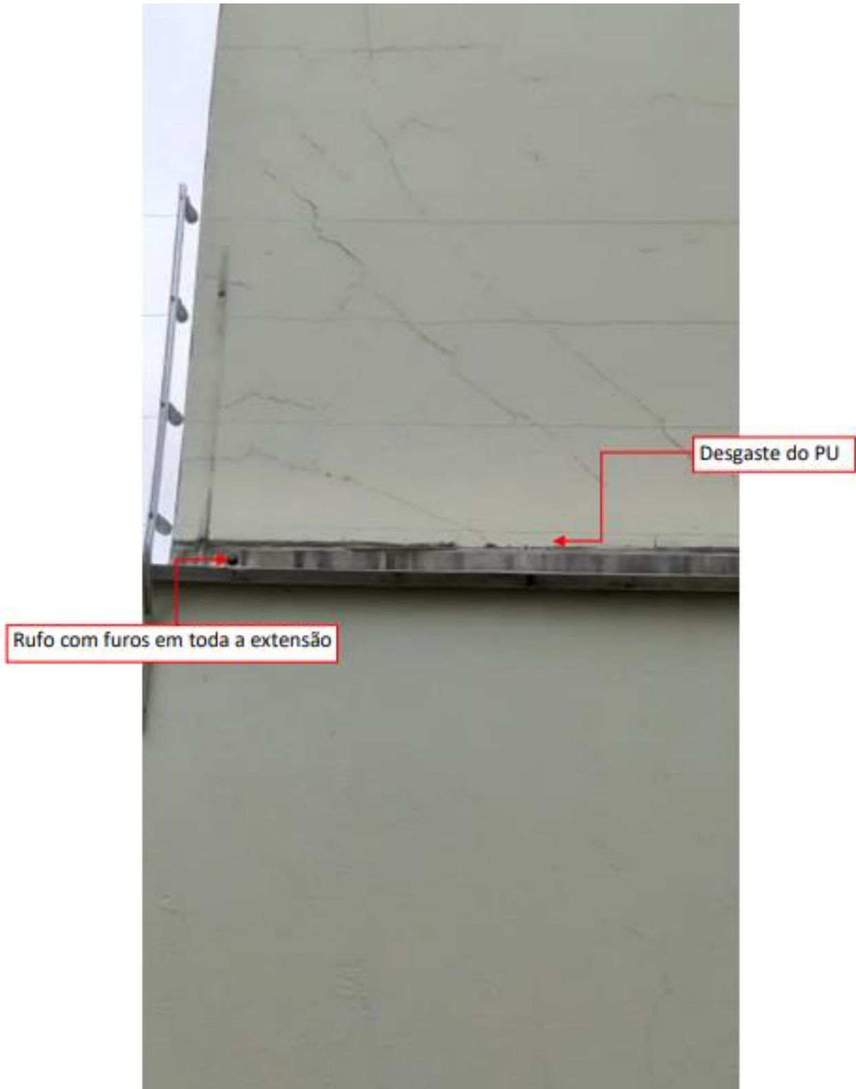
Figura 2: Parede a ser reparada
