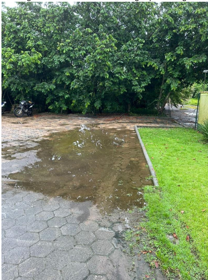
Figura 3: Local com acúmulo de água para corrigir
