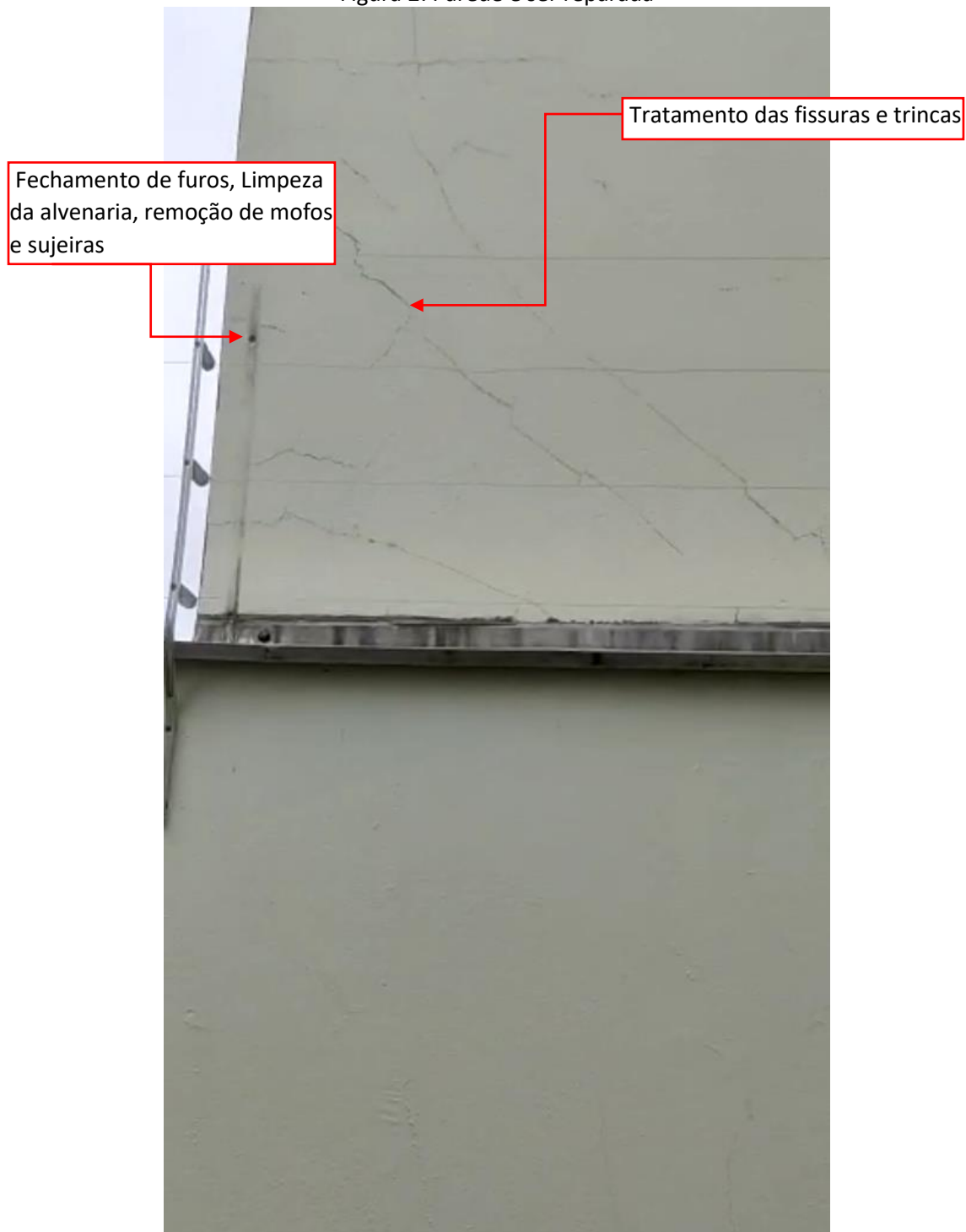
Figura 2: Parede e ser reparada
