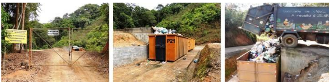
Figura 22 – Estação de transbordo de RSD de Massaranduba
