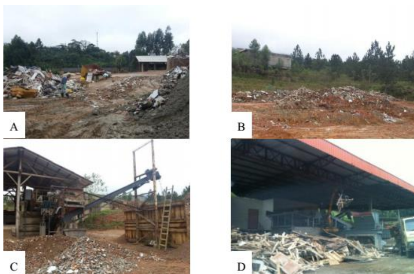
Figura 49 – Reciclagem de RCC da empresa Transpézia Ltda.: área de triagem (A), material triado pronto para o beneficiamento (B), beneficiamento do concreto (C) e beneficiamento da madeira (D).
